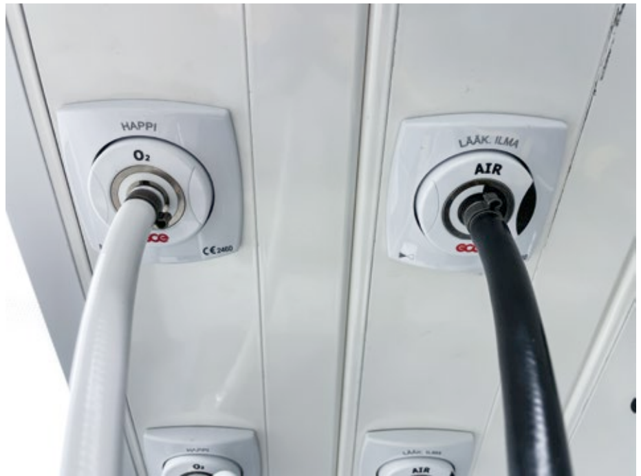
Kuva 1: Ilmanpaine putkistossa 5bar, hapen paine 4bar.
